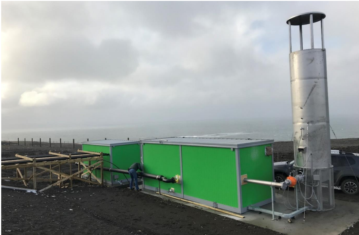
MYND 5-45 Gassöfnunarstöðin við Stekkjarvík. Mynd tekin við uppsetningu í október 2018.
